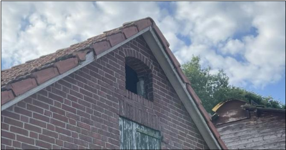
Invliegopening voor de kerkuil in de te slopen melkstal binnen het plangebied.
