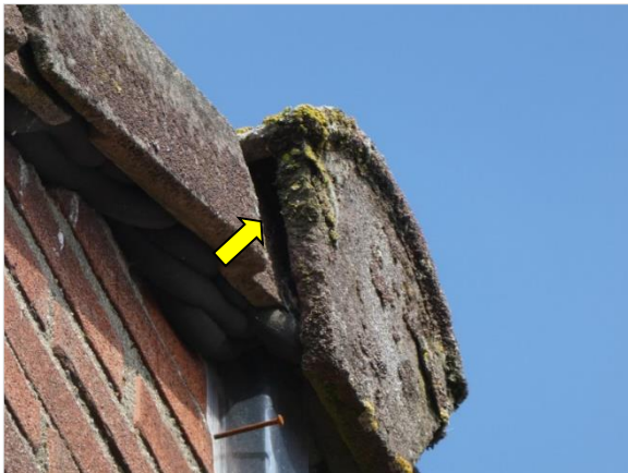
Figuur 4.3 Mogelijke invliegopening onder kantpan die niet volledig ongeschikt gemaakt is.
