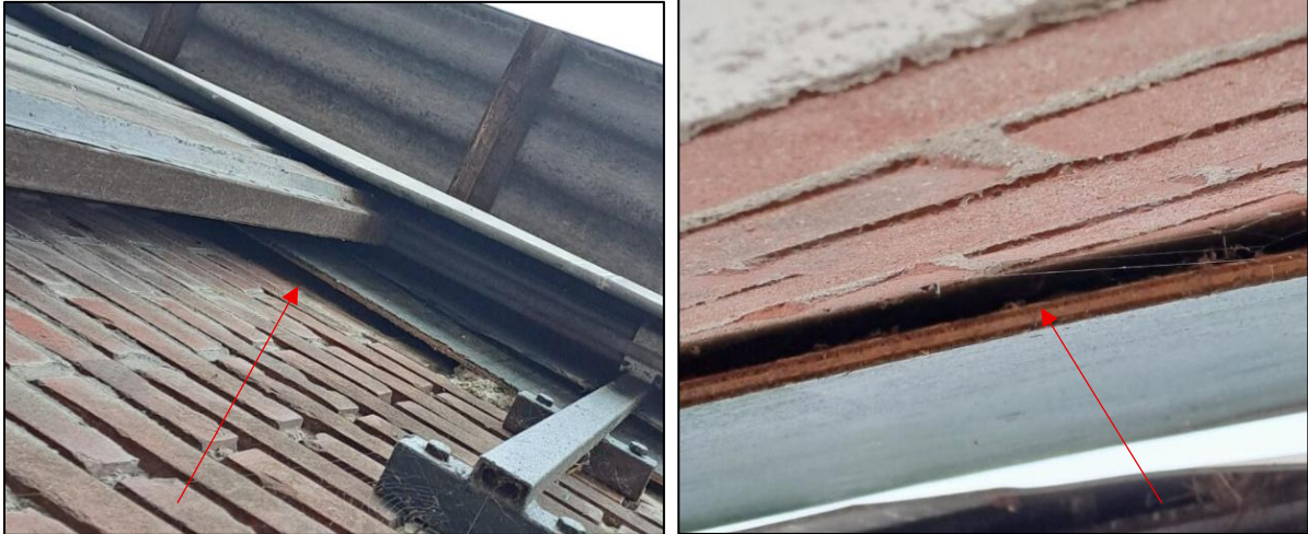
Foto 1 en 2: de gevelbetimmering kiert op het metselwerk waardoor vleermuizen een verblijfplaats kunnen bezetten achter deze delen.
