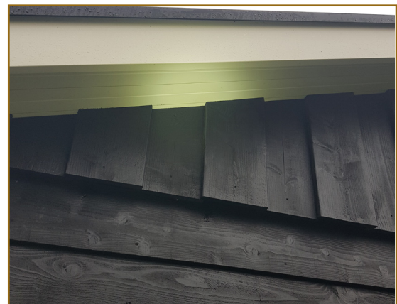
Afbeelding 15: Tijdelijke woonunit. Geen openingen bij overstek aanwezig.
