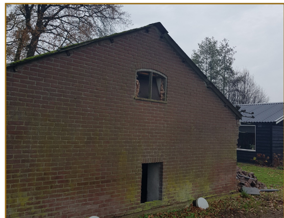
Afbeelding 7: Zuid-oostzijde van het plangebied. Kopse kant van de kalverenstal (nummer 2 op afbeelding 3). De dakbedekking sluit strak aan op de muur.
