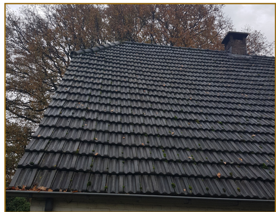
Afbeelding 25: Midden van het plangebied. Dak van de woning. Geen ruimte onder de dakpannen door platte dakpannen en doordat de nokpannen zijn afgewerkt met cement.
