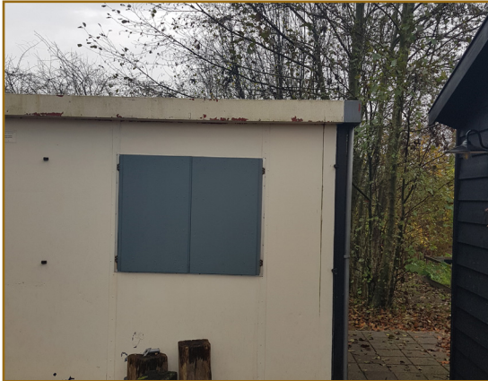
Afbeelding 16: Tijdelijke schaftvoorziening. Geen openingen aanwezig.
