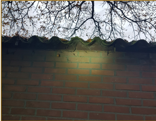
Afbeelding 10: Kalverenstal openingen onder golfplaten, dicht door hout.
