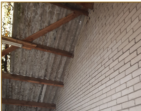
Afbeelding 8: Binnenkant van de loods. Steens muur zonder spouw en de dakbedekking is van binnen uit volledig te overzien.
