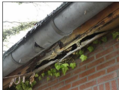
Figuur 5.11 Invliegopening bij de verrotte betimmering van de dakrand van het hoofdgebouw.
