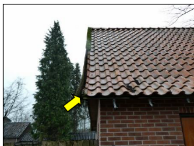
Figuur 5.7 Betimmering die weggerot is bij de garage.
