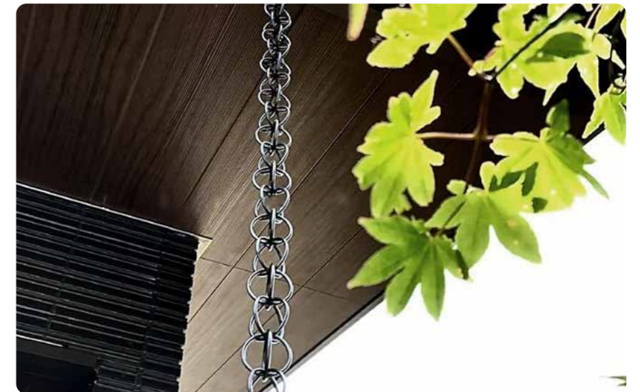
Water van het dak zichtbaar door ketting in plaats van regenpijp
