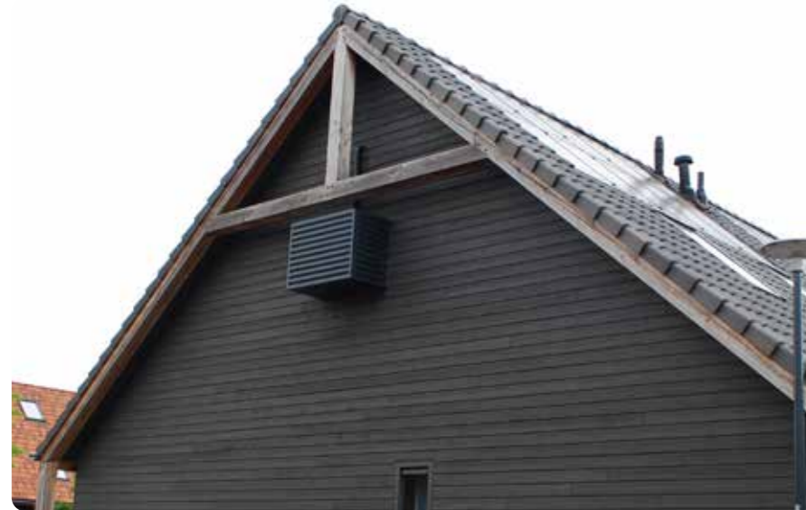
Installaties bouwkundig ingepast
