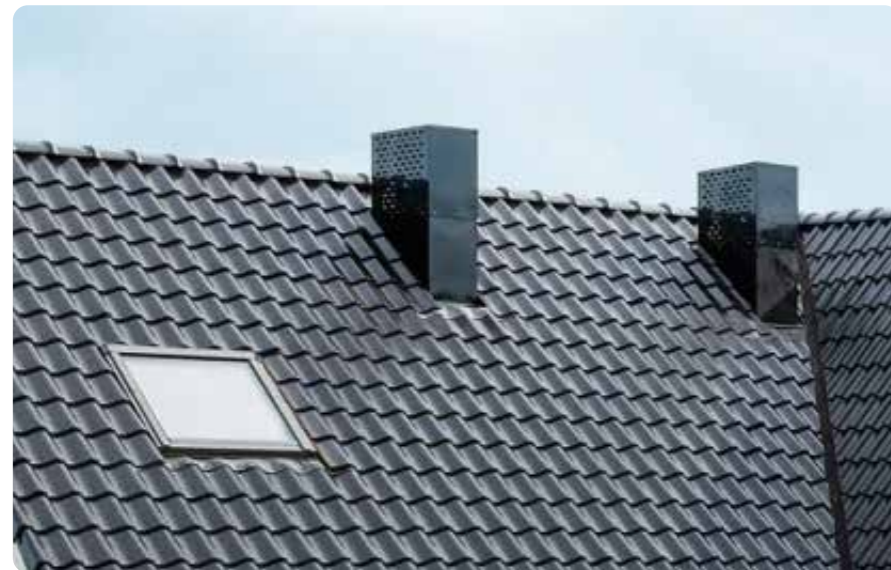
Installaties bouwkundig ingepast als een schoorsteen
