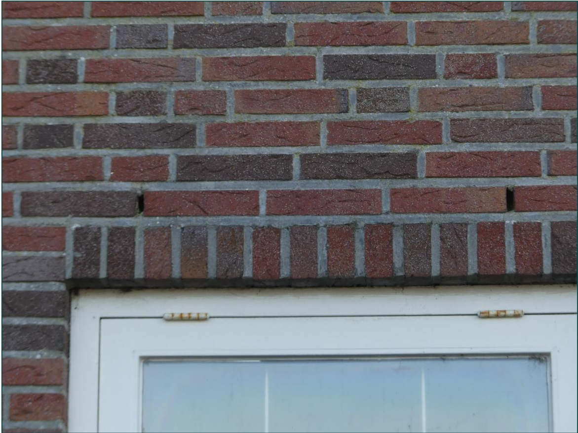
Figuur 3.1 In de bedrijfswoning zijn stootvoegen aanwezig.
