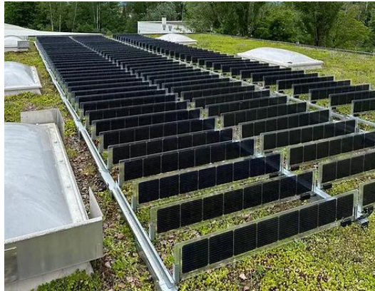
Figuur: Verticale zonnepanelen geplaatst op een groen dak. Bron: www.overeasy.no
