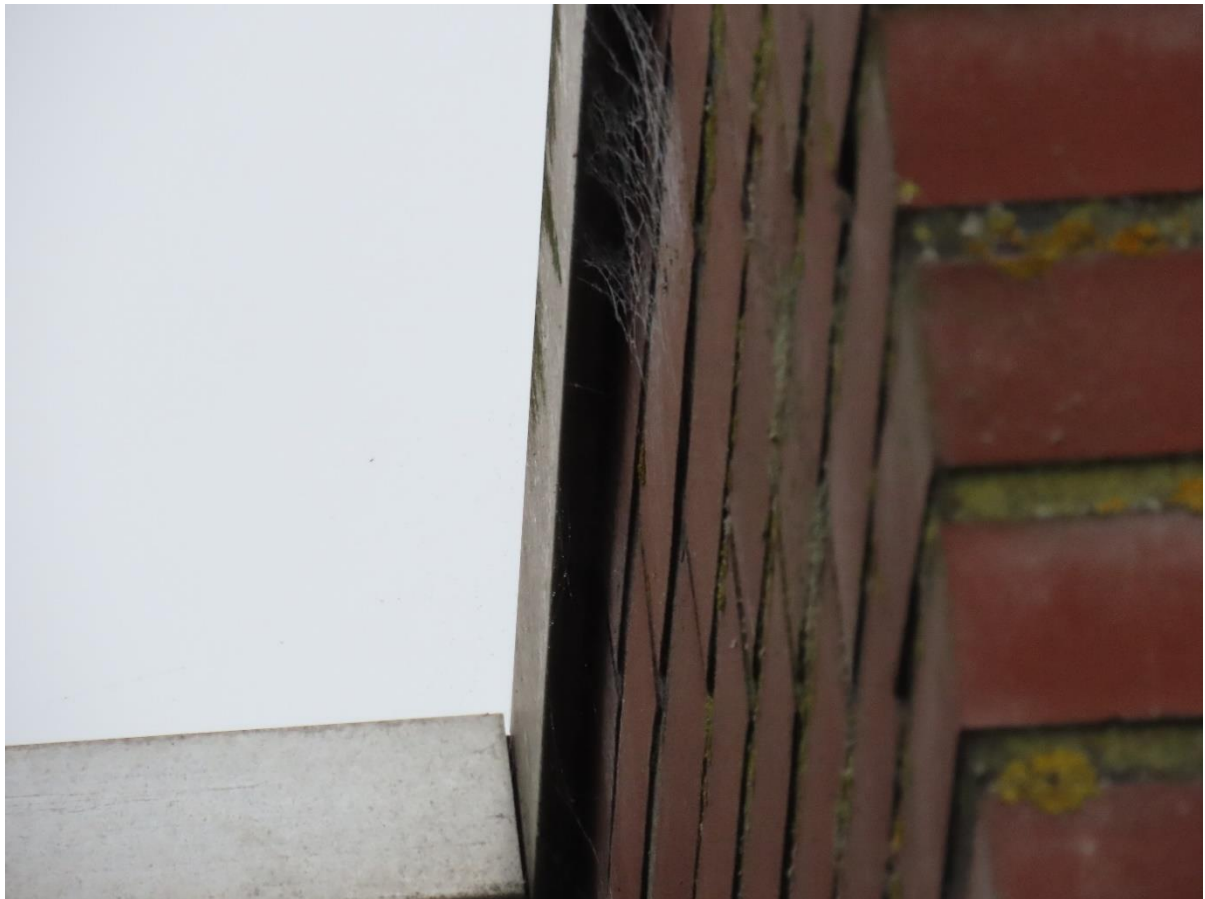
Figuur 2.1. Achter daklijsten werden voor vleermuizen geschikte ruimtes aangetroffen.
