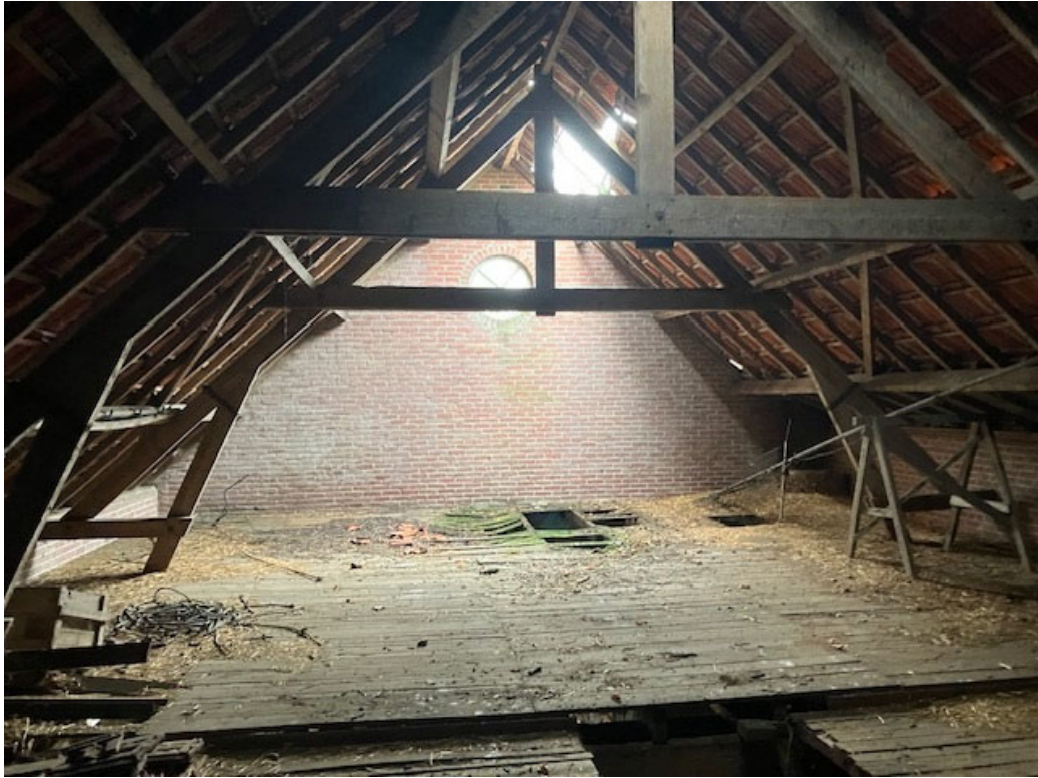
• Afbeelding 29: Zolder, kap is heel erg slecht door lekkages
