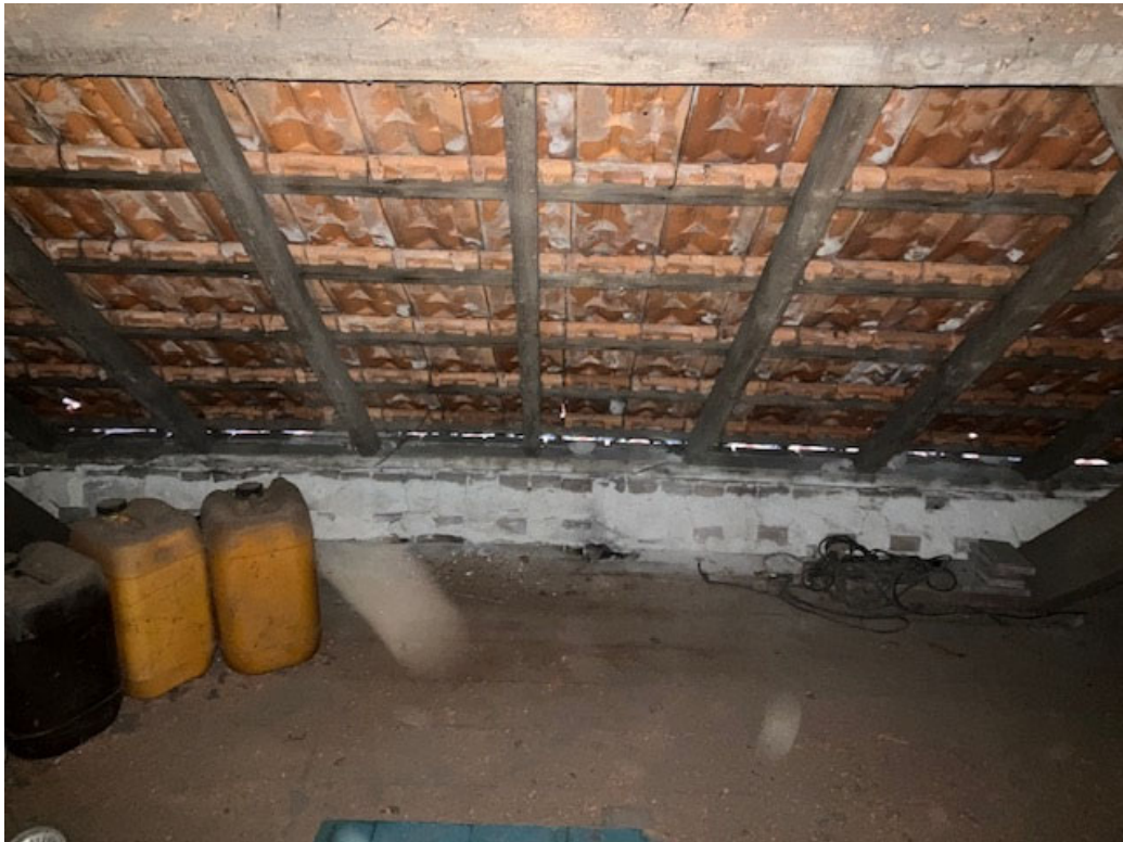
• Afbeelding 26: Dakaansluiting boerderij is steens
