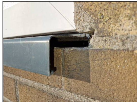
Afbeelding 6: Ruimte onder raamkozijn
