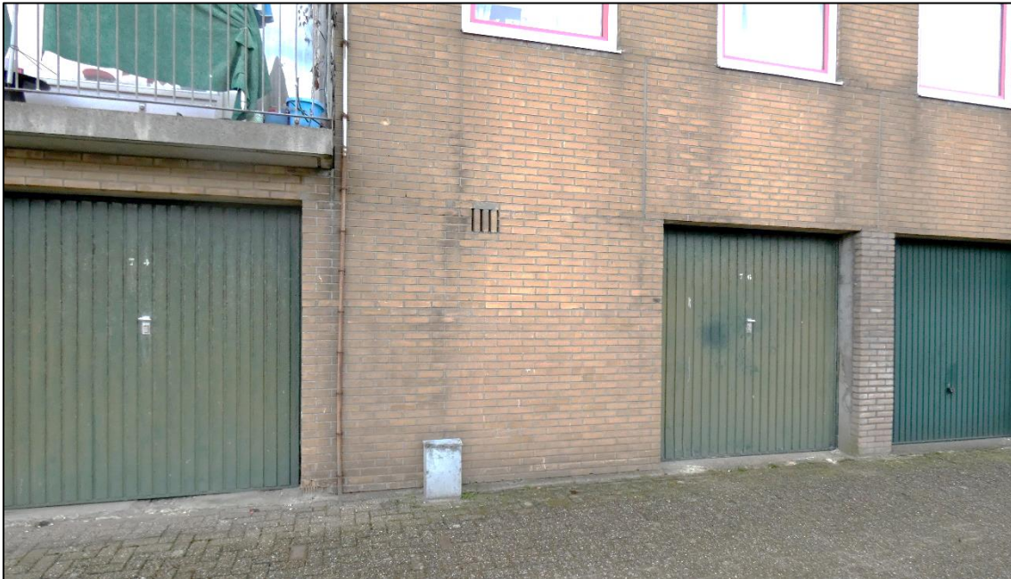
Figuur 10: Op de eerste verdieping van enkele gebouwen zitten grote open stootvoegen aan de lange zijden van het gebouw. Hier kunnen vleermuizen door naar de spouwmuur kruipen om daar een verblijfplaats te hebben.
