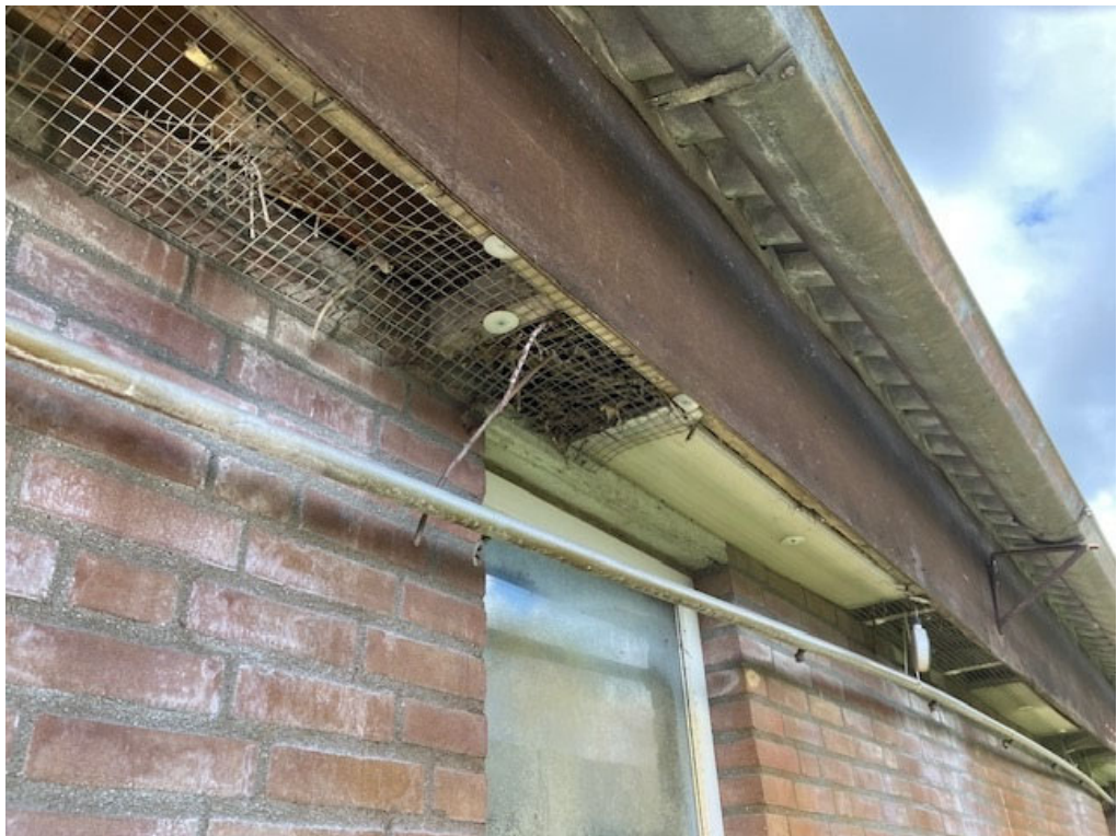
• Afbeelding 16: Onderzijde dak si afgewerkt met plaatmateriaal, onder het gaas zijn nesten van kauwen aanwezig
