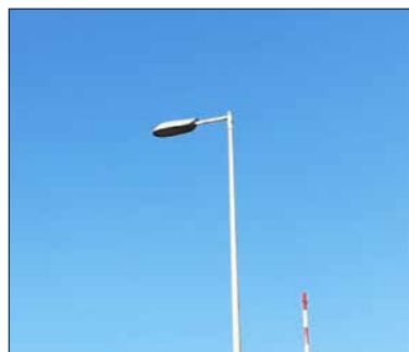
▲ 6 m hoge mast met koffer armatuur
