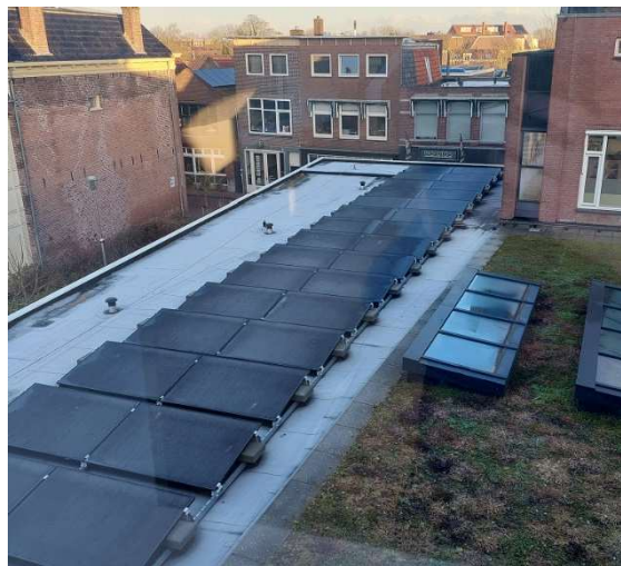
Foto: zonnepanelen centrale huisvesting Sneek.
