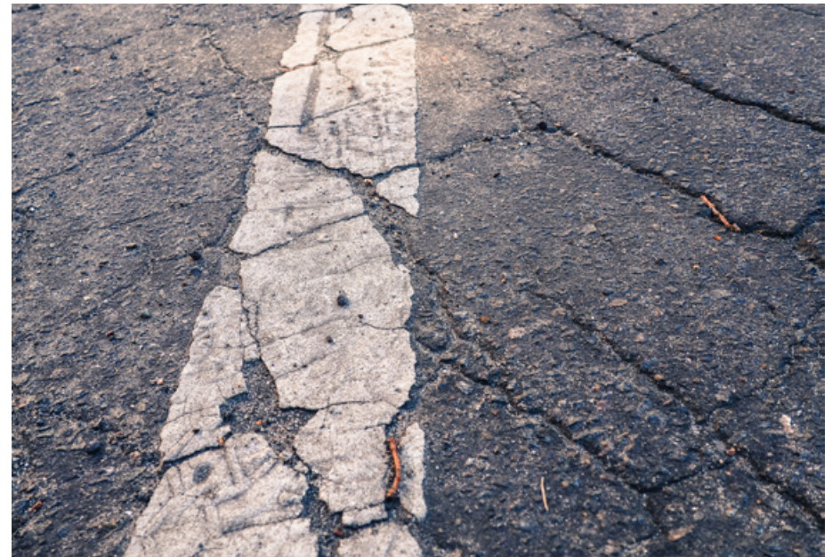
▲ Droogte kan zorgen voor schade aan wegen.
